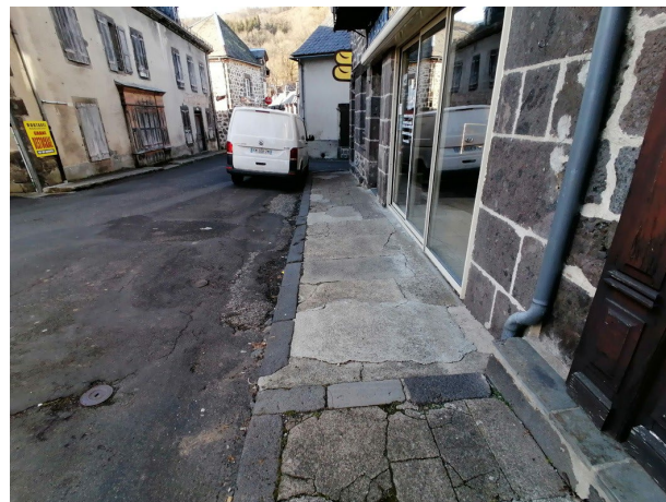
Trottoirs en mauvais état, non accessibles et irréguliers. Ils seront démolis et remplacés par du béton désactivé et/ou du dallage. Les marches seront majoritairement effacées.
