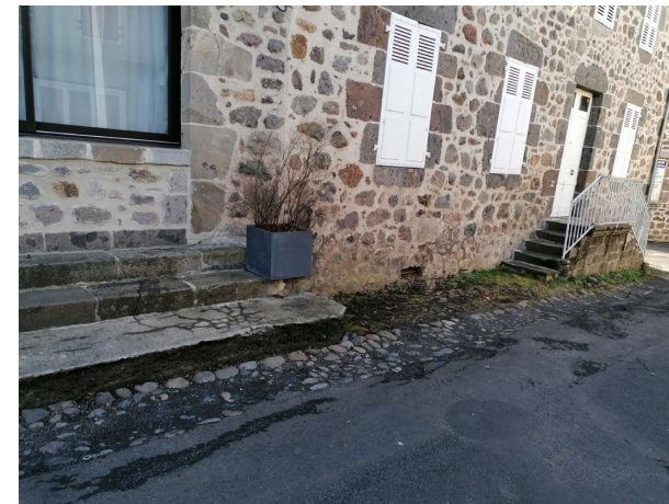
Les calades existantes de galets sont déposées et reposées dans le cadre de la préservation du patrimoine et de la gestion des eaux pluviales.
